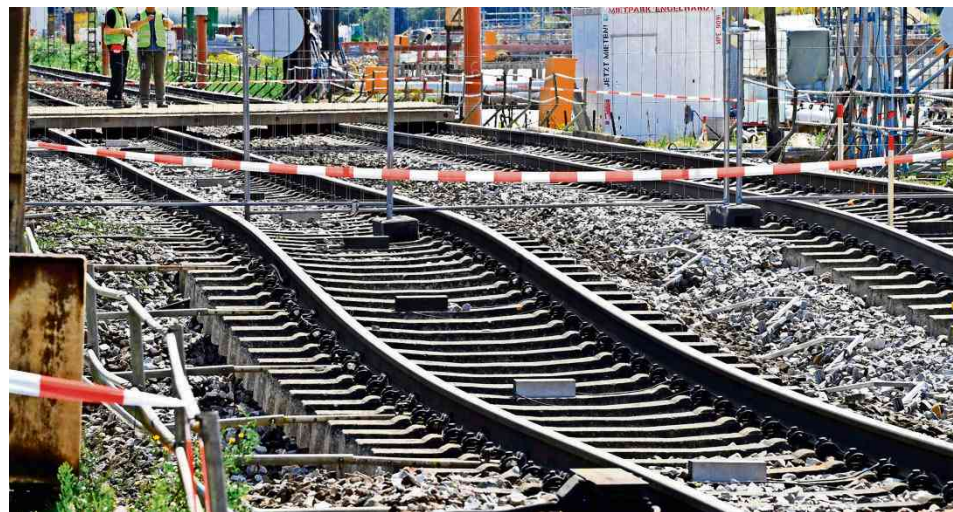
Ein wildes Wellental – nach der Havarie Mitte August 2017 hatten sich die Bahngleise an der Rheintalstrecke auf Höhe Rastatt an einigen Stellen abgesenkt.
